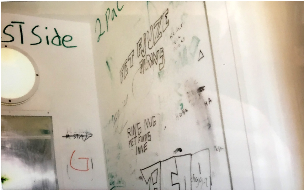
Bild 11. Foto taget av en kille över badrummet med klotter på väggarna.
